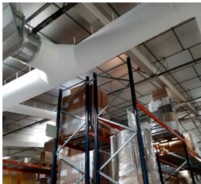
Lieu : Rennes Équipements installés : VRF, Gainables
